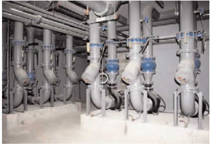
Le local de distribution de l'eau glacée
