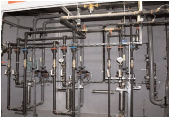
Une sous-station de distribution d'eau froide
