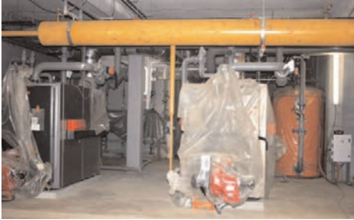
Deux des 3 chaudières pour le chauffage de l'hôpital
