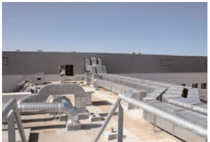
Sur le toit, des gaines de ventilation
