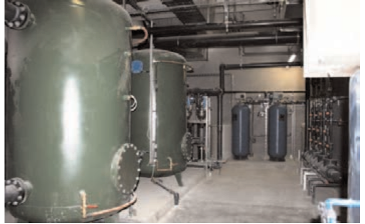
Le local général d'eau potable
